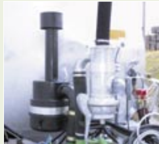
Ölabscheider-Siphon mit Kugelventil
